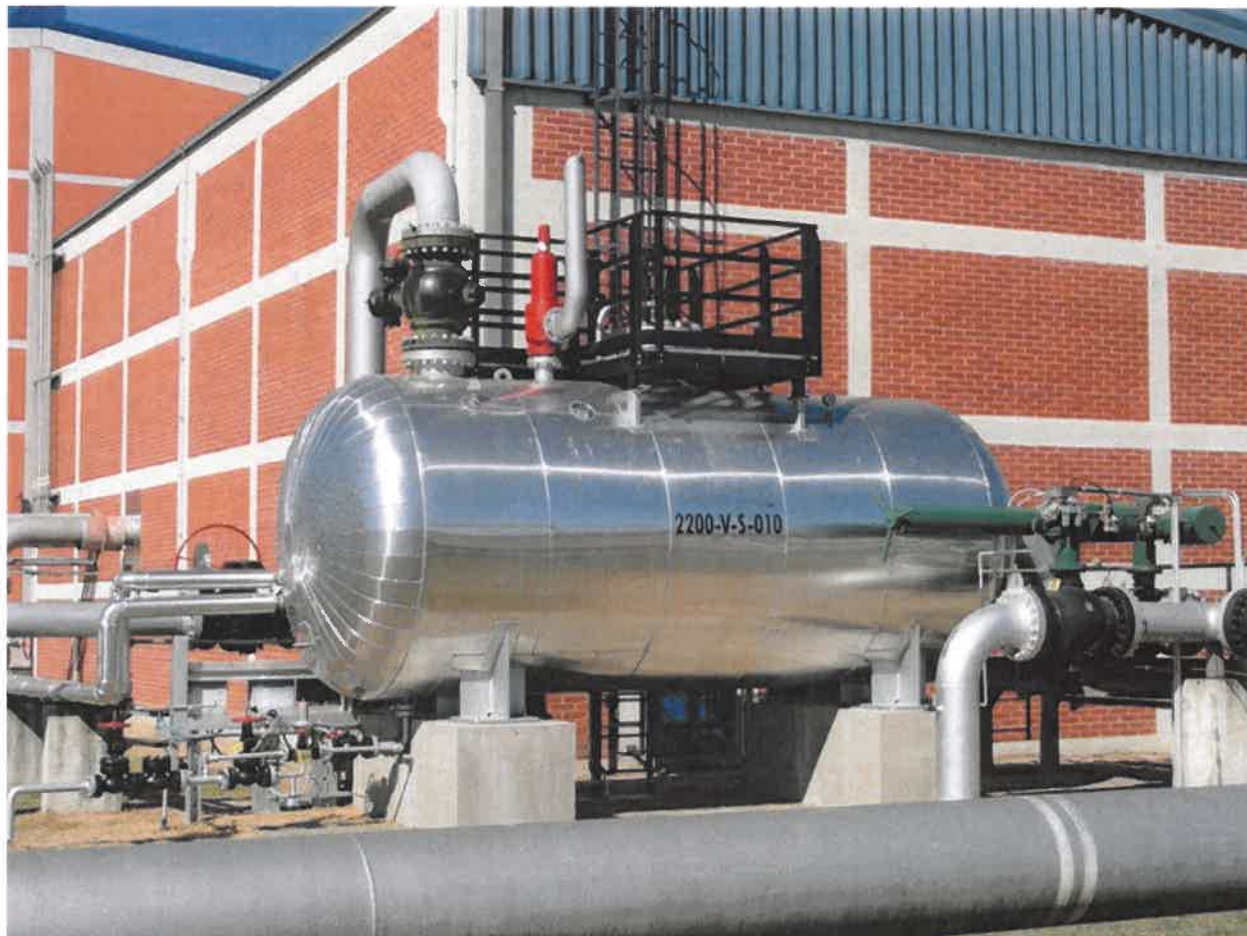
Slika 5. Novi ulazno-izlazni separator kapaciteta 240.000 m 3 /h plina
